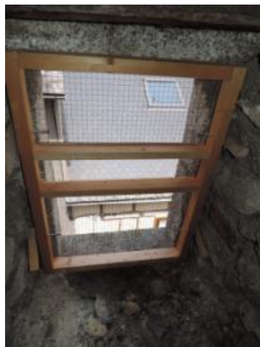
Passage à chauves-souris dans une fenêtre grillagée d'une église (© L. Campourcy)
